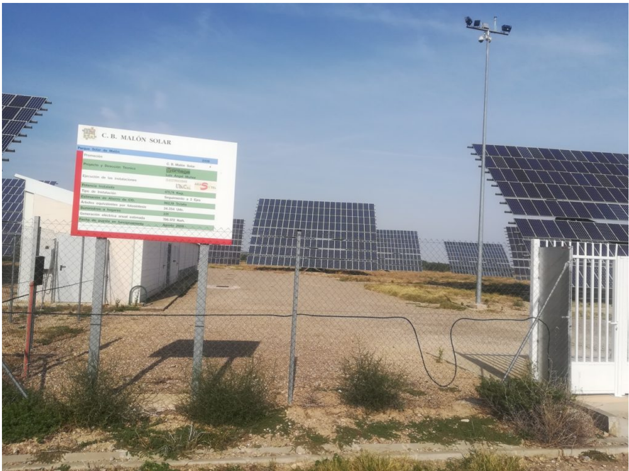
Ferme solaire. Production annuelle 780 000 Kwh. Si un ménage consomme 2000 Kwh par an, hors-chauffage et climatisation, cela correspond aux besoins de 400 ménages environ. Un peu plus tôt dans la journée, j'ai vu une autre ferme solaire, moins sophistiquée, panneaux posés au sol et non réglables. Ici, la position des panneaux peut-être optimisée en fonction de l'orientation du soleil et de son élévation dans le ciel.
